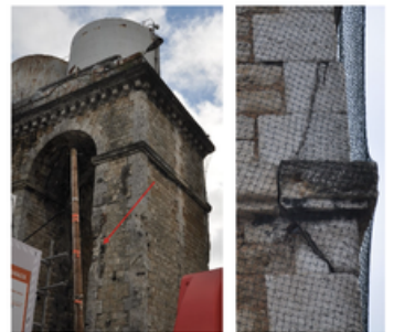
Fissures importante façade ouest et angle Sud-Est
