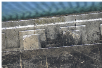
composition s'achève par une terrasse sommitale sur laquelle 4 socles circulaires pierre de taille supportent les citernes.
