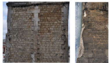
Perte de matière façade Sud-Ouest
